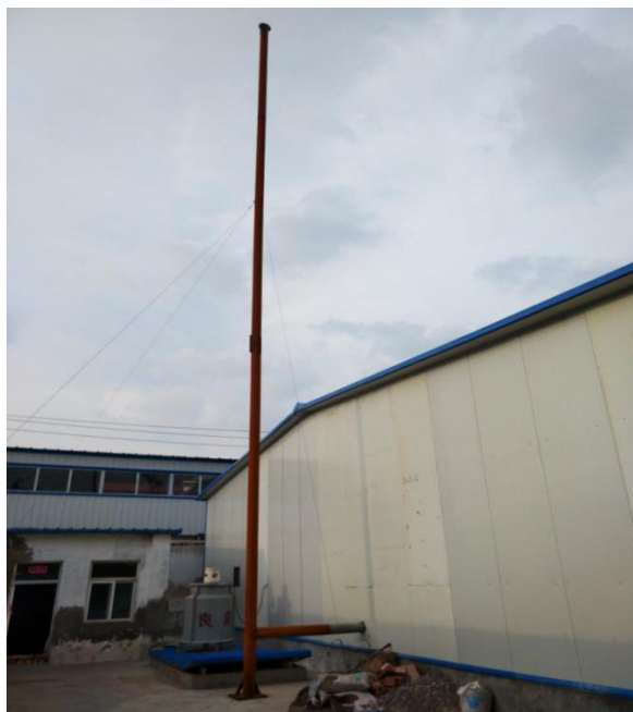
15m 高排气筒
