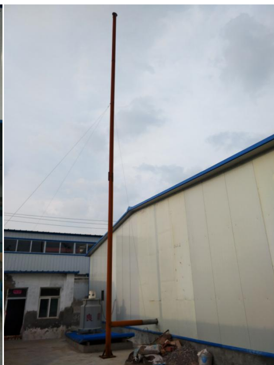
15m 高排气筒
